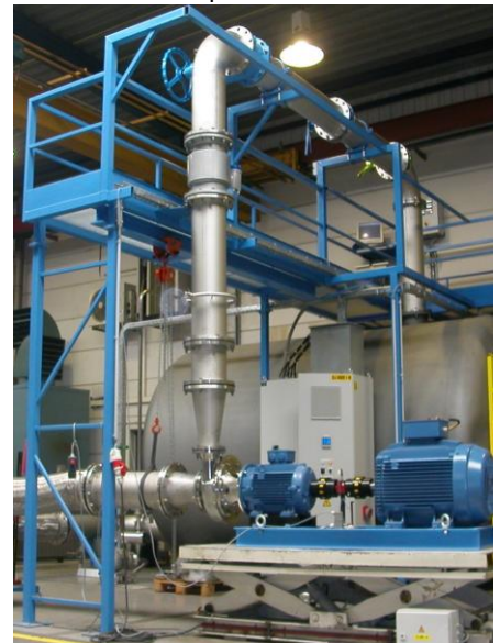
Illustration 1. Stand expérimental avec des conduites d'un diamètre de 300 mm, un convertisseur de fréquence de 110 kW, pour des pompes avec un débit jusqu'à 1000 m 3 /h.
